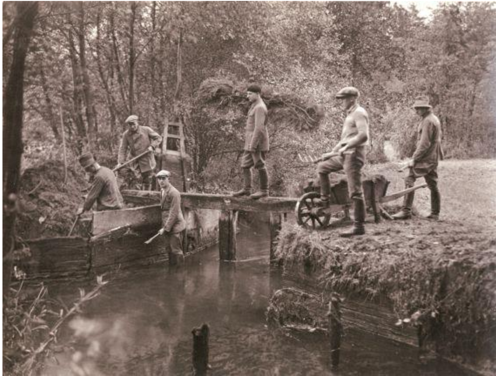
Instandsetzungsarbeiten an einer Stauschleuse in der Hardau durch Schüler der Wiesenbauschule um 1930 (KHG, Sammlung Baumgarten, Museumsdorf Hösseringen)
